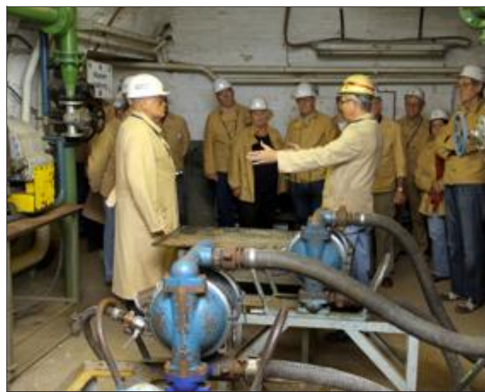
Le guide explique le fonctionnement de la salle des pompes d'exhaure.
